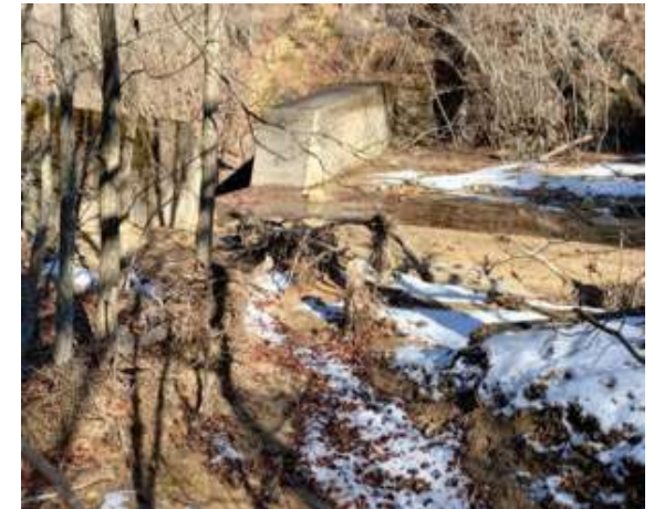
土砂で埋まってしまった砂防ダム
